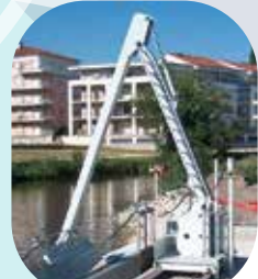
Dégrilleurs hydrauliques mobiles et fixe
